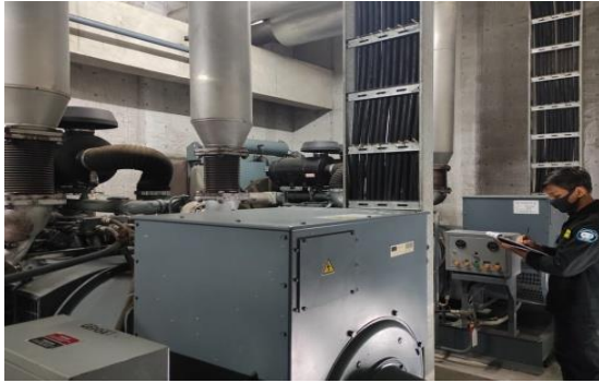
Gambar II.1 Generator Set Stamford dengan daya 670 kVA.
