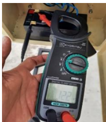
Gambar 3. 17 Pengukuran Tegangan Baterai 12 Volt
